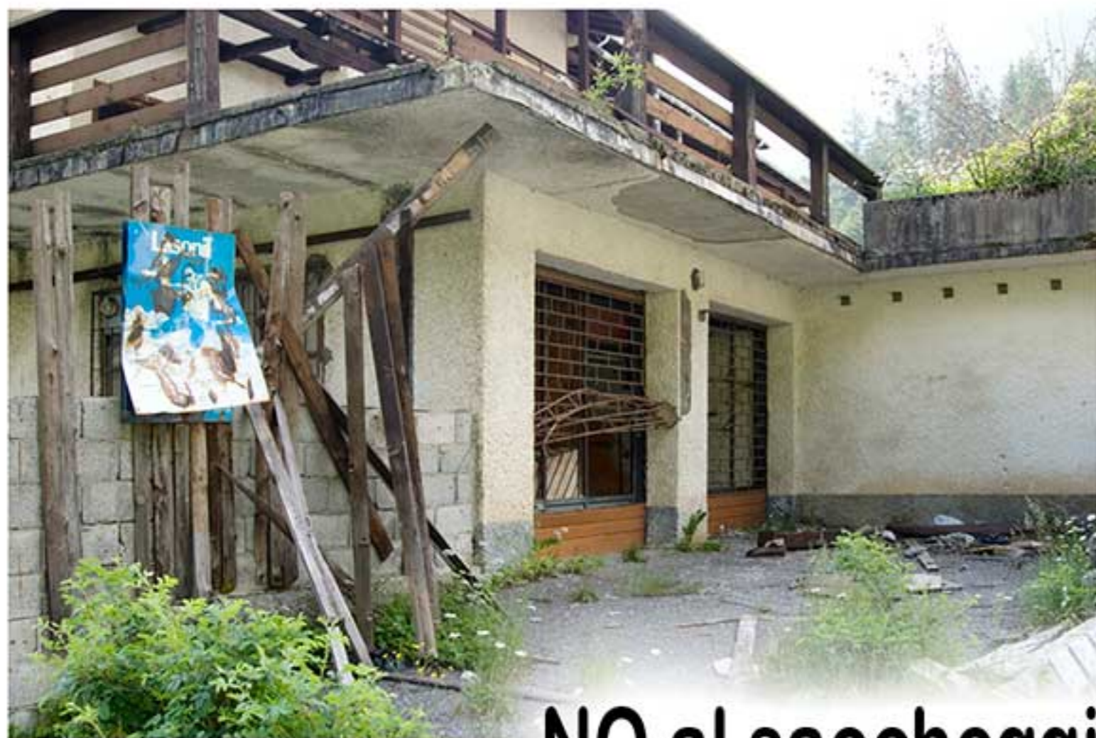
Valcanale: degrado dell'albergo "Sempreveve"
