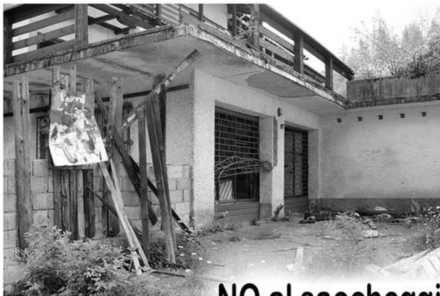
Valcanale: degrado dell'albergo "Sempreneve"
