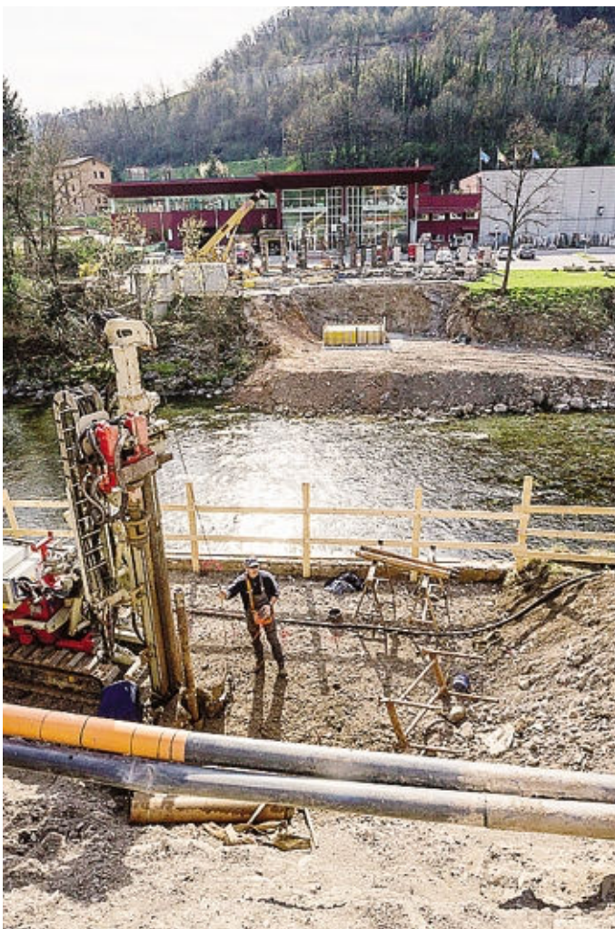
I lavori sulle sponde per la passerella: costerà 300 mila euro FOTO ROTA
